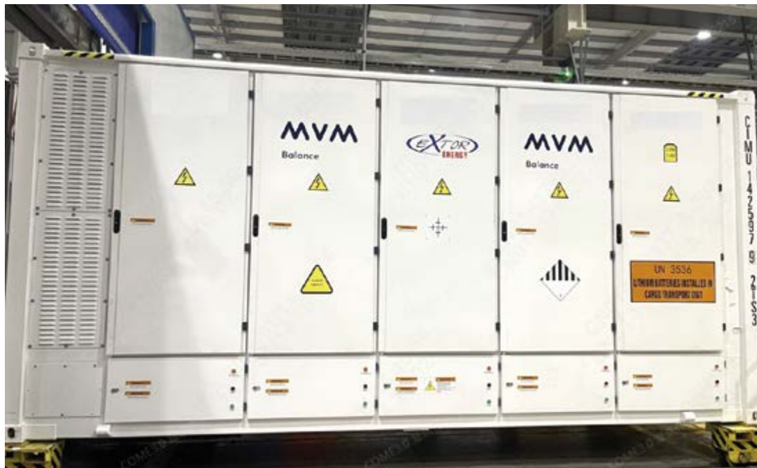
Bakonyi Hibrid Erőmű energiatárolójának első akkumulátor konténere Fotó: MVM Balance Zrt.
